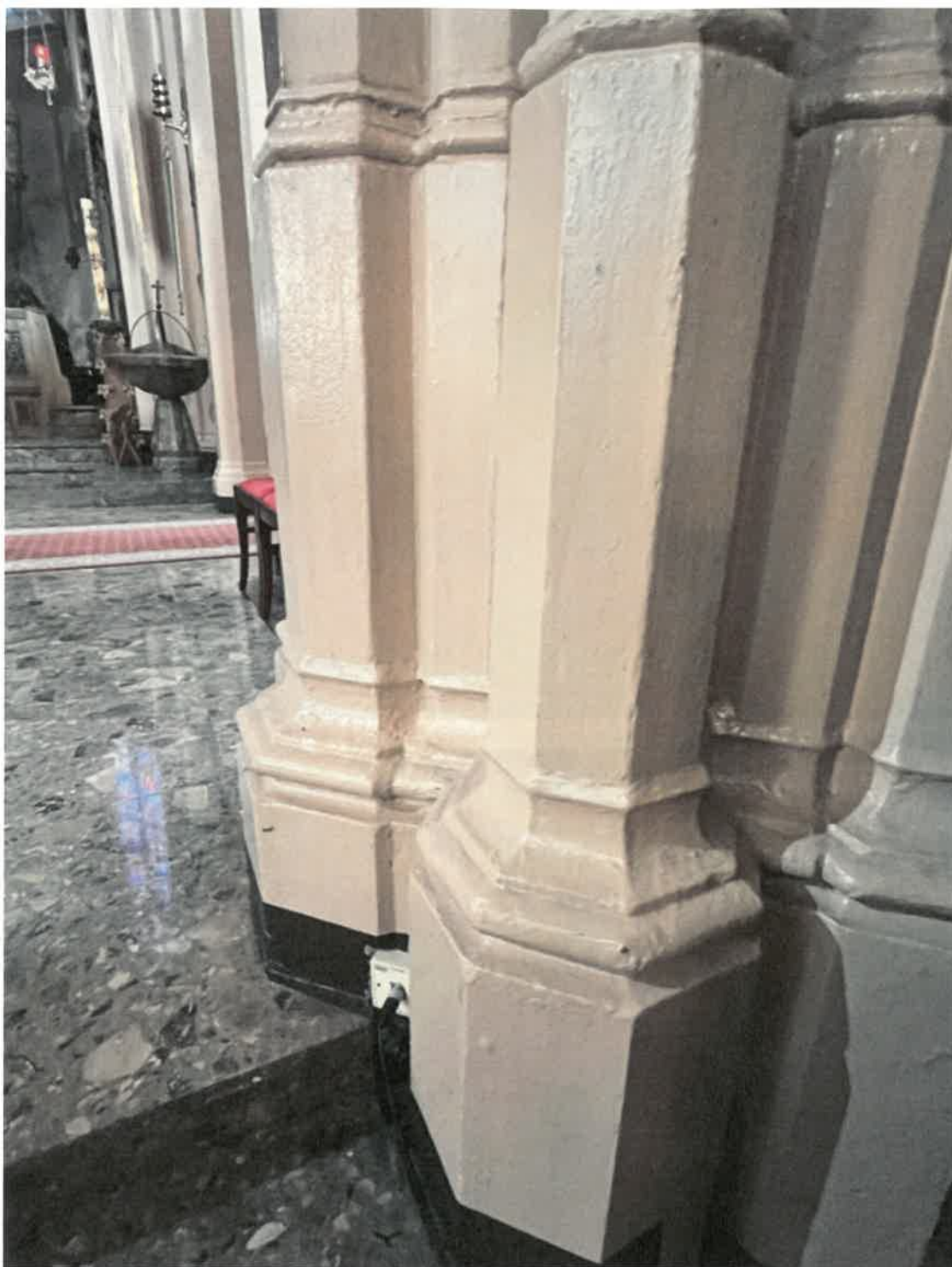
Fot. nr 28 Kościół p.w. św. Trójcy i św. Józefa w Wilamowicach. Ściana północna, fragment strefy z lamperią. Widoczne nawarstwienia olejne zatracające wyrazistość profili gzymsów.
