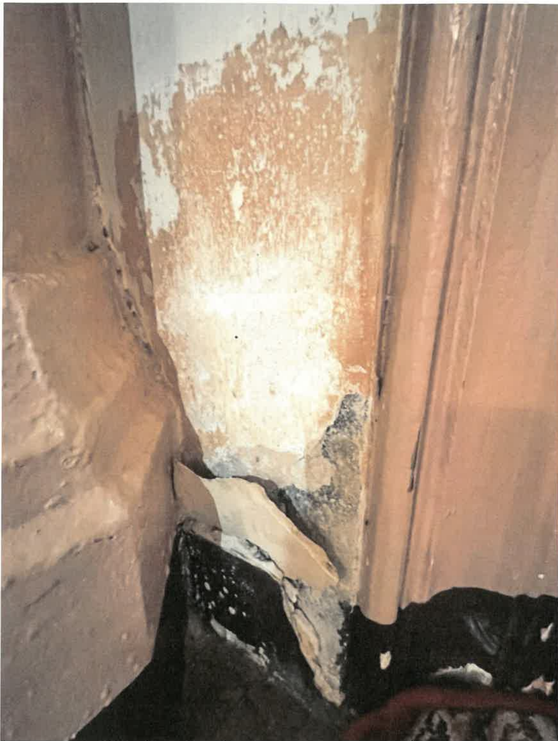
Fot. nr 32 Fot. nr 33 Kościół p.w. św. Trójcy i św. Józefa w Wilamowicach. Ściana północna, fragment strefy z lamperią. Widoczne odspojenia tynków strefie nad posadzką.
