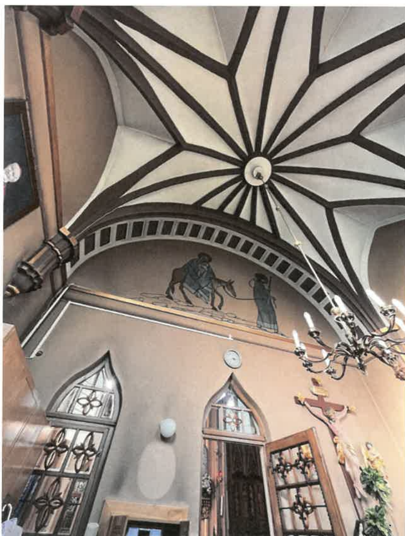
Fot. nr 34 Fot. nr 35 Kościół p.w. św. Trójcy i św. Józefa w Wilamowicach, zakrystia. Widoczne ogólne zabrudzenie ścian.
