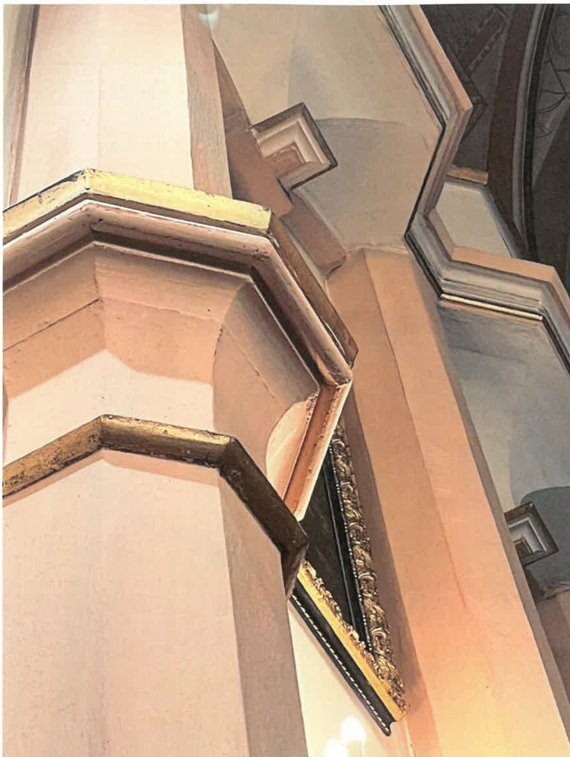
Fot. nr 26 Kościół p.w. św. Trójcy i św. Józefa w Wilamowicach. Widoczne zabrudzenie ścian, ściemnienie i przetarcia warstwy szlagmetal.
