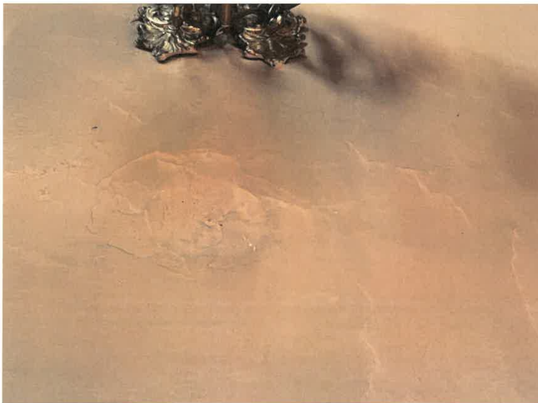
Fot. nr 24 Fot. nr 25 Kościół p.w. św. Trójcy i św. Józefa w Wilamowicach. Widoczne zabrudzenie ścian, siatka rys skurczowych, naprawy ścian, nierówno wyprowadzone profile parapetów i gzymsów.
