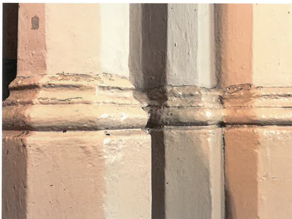
Fot. nr 22 Kościół p.w. św. Trójcy i św. Józefa w Wilamowicach. Ściana północna, fragment strefy z lamperią. Widoczne nawarstwienia olejne zatracające wyrazistość profili gzymsów. Fot. nr 23 Kościół p.w. św. Trójcy i św. Józefa w Wilamowicach. Strona północna, widoczne zabrudzenie ściany nad boazerią.
