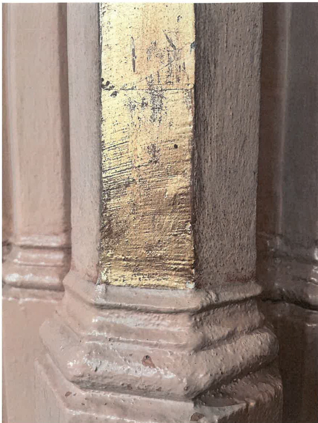
Fot. nr 31 Kościół p.w. św. Trójcy i św. Józefa w Wilamowicach. Ściana północna, fragment strefy z lamperią. Widoczne nawarstwienia olejne zatracające wyrazistość profili gzymsów i przetarcia warstwy szlagmetal.
