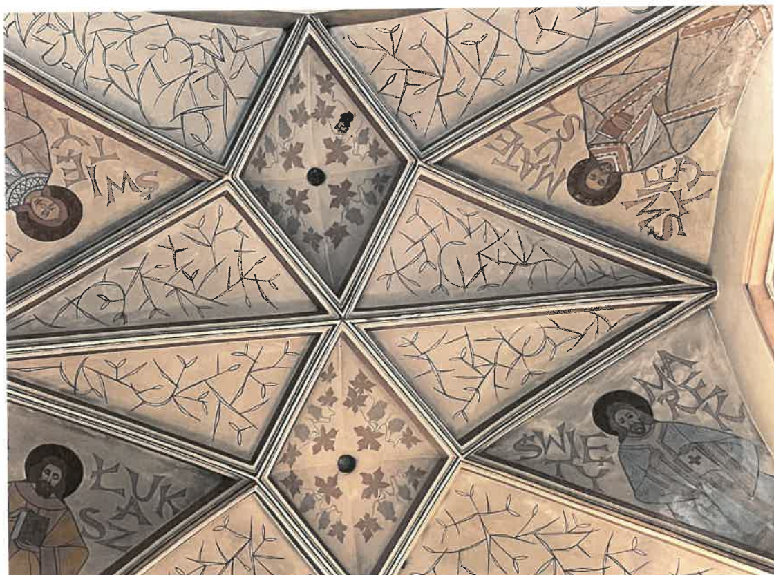
Fot. nr 19 Fot. nr 20 Kościół p.w. św. Trójcy i św. Józefa w Wilamowicach. Fragment sklepienia prezbiterium, widoczne ogólne powierzchniowe zabrudzenie, przetarcie lub pudrowanie się malowidła, ewentualne zasolenie, na skutek dawnego zacieku (żagle z wizerunkami świętych).
