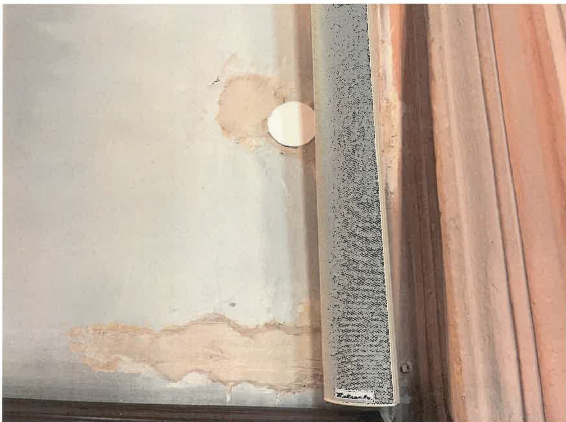
Fot. nr 29 Kościół p.w. św. Trójcy i św. Józefa w Wilamowicach. Strona północna; widoczna olejna lamperia w obrębie profili filarów, złuszczenia oraz odspojenia farb i tynków w strefie nad posadzką. Fot. nr 30 Kościół p.w. św. Trójcy i św. Józefa w Wilamowicach, ściana południowa, widoczne Naprawy ścian.
