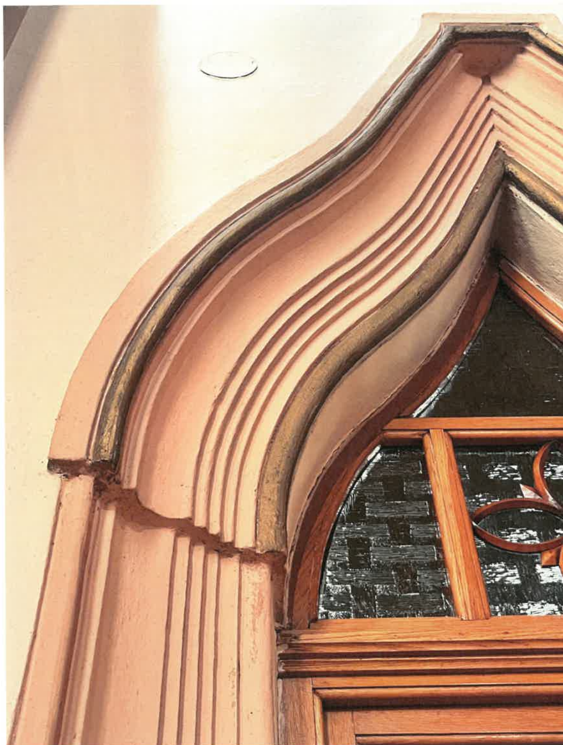
Fot. nr 27 Kościół p.w. św. Trójcy i św. Józefa w Wilamowicach. Widoczne zabrudzenie ścian, miejscowe przetarcia i złuszczenia farby, ściemnienie i przetarcia warstwy szlagmetal.
